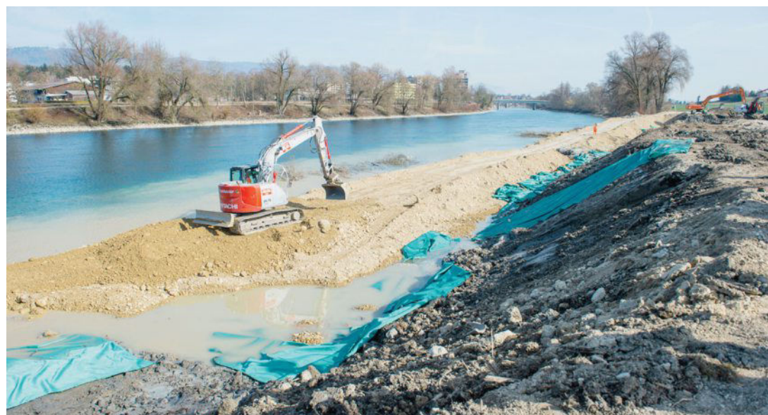
Les travaux d'excavation dureront jusqu'en avril. Puis, la berge sera réaménagée. PETER SAMUEL JAGGI
