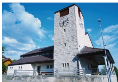
Il faut assainir le porche d'entrée de l'église, dont la toiture présente des signes de fatigue. LDD
