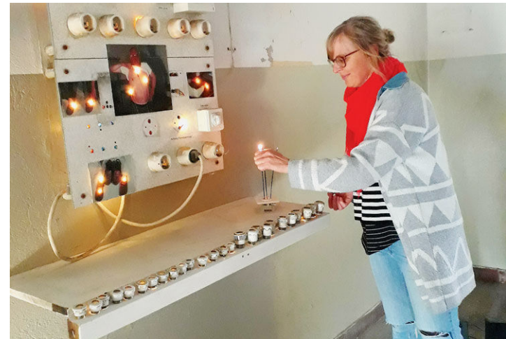
Interpellée par un vieux tableau électrique, la Biennoise Nadja Gubler a imaginé rendre hommage à l'électricité. SALOMÉ DI NUCCIO
