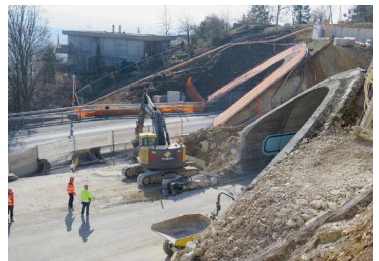
Le portail sud de la voie montante va être démolé pour être ensuite reconstruit. Il en ira de même pour la voie descendante. PH. OUDOT
