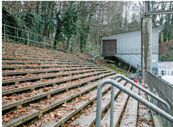
Auch die Zuschauertribüne sind sanierungsbedürftig. Die Anlage muss unter anderem erdbebensicher gemacht werden. Foto: Nicole Pont
